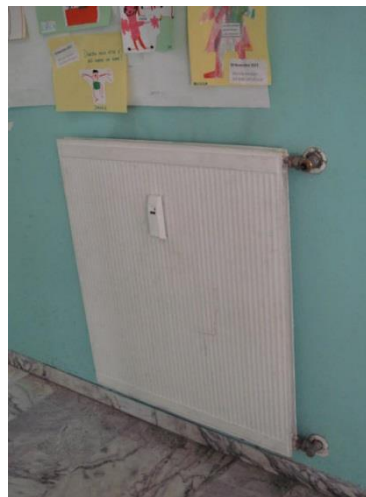
Figura 4.9 - Particolare radiatore in acciaio con valvola termostatica danneggiata
