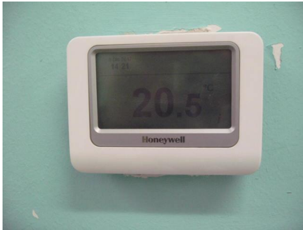
Figura 4.10 - Particolare del termostato ambiente.
