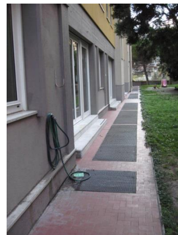
Figura 4.2 - Particolare della facciata Nord con in evidenza le griglie della relativa intercapedine fra edificio e terreno al piano sottostante
